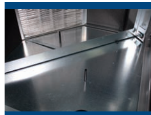
Pressure drop for filters maintenance control. Toma de presión para control de mantenimiento de filtros.
