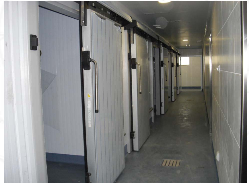
PASILLO CÁMARAS FRIGORÍFICAS
