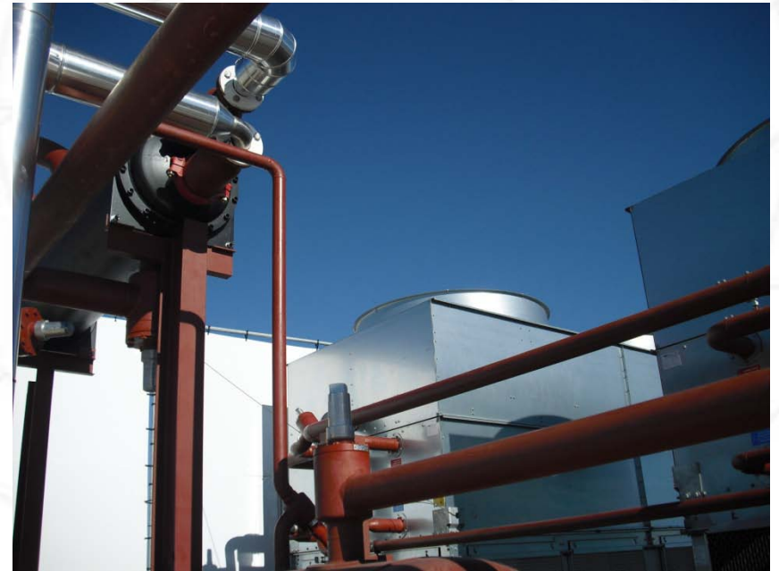
RECUPERACIÓN CALOR ZONA CONDENSADORES
