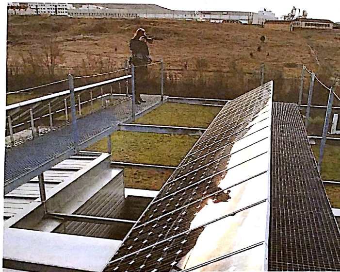
Placas solares fotovoltaicas, en el tejado del edificio del Cenifer. Foto: Javier Bergasa
