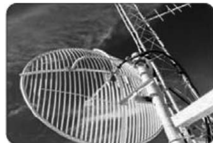
Estación receptora radio y TV
